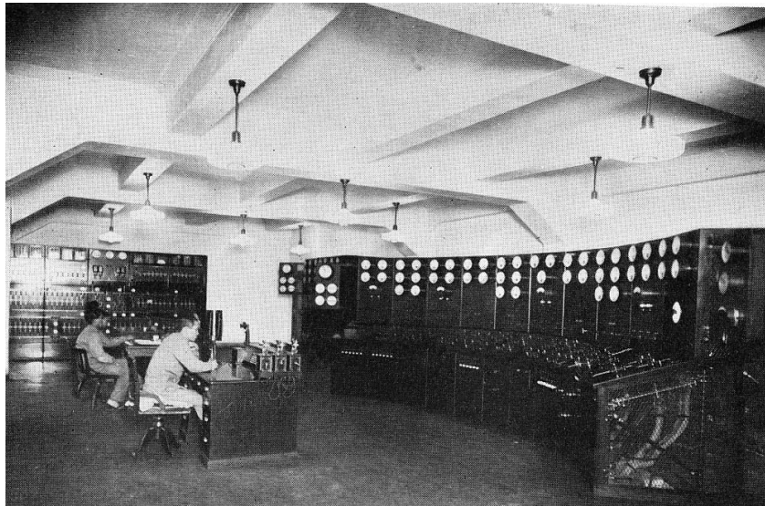
東洋一の火力発電所 鉄道省の川崎発電所の配電盤室
